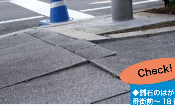
隆起と陥没?下の写真のように浮いてしまっている箇所も
